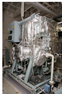
搭載された吸収式冷凍機
