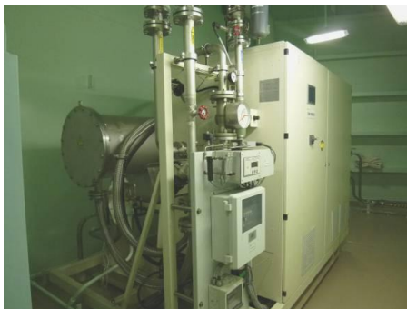
オゾン発生装置
