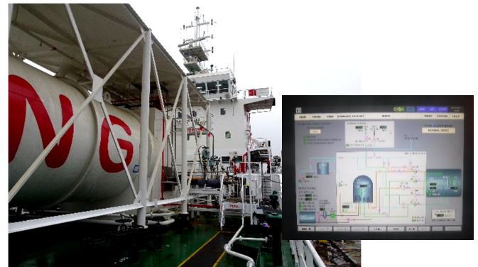
【本船に搭載された LNG タンクと操作パネル】
