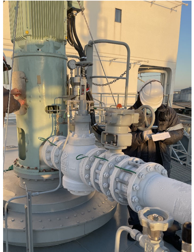
【低温カーゴ移送試験 (配管表面氷結)】
